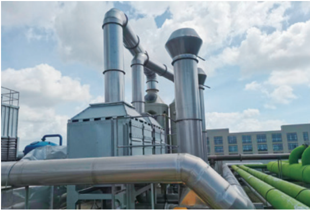
舜宇浙江光學廢氣處理設施
