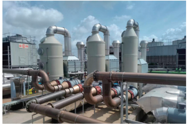
舜宇浙江光學廢氣處理設施
